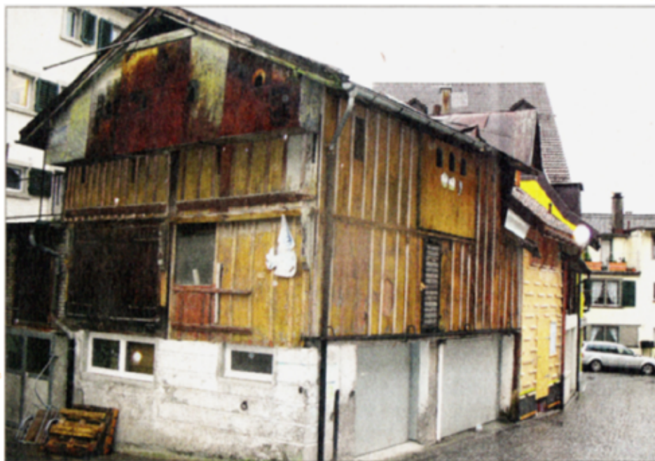
Hier in der Kruggasse, an der Stelle, wo das baufällige «Bühler-Haus» der Ortsgemeinde steht, soll demnächst das neue Ortsmuseum Weesen errichtet werden. (bla)
